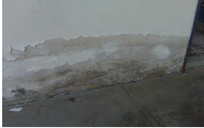
Figura 40. Filtración de Pabellón 6
