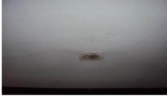
Figura 37. Tomacorriente de CB1
